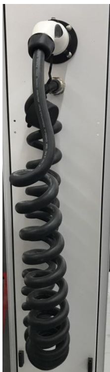
Rys.28.1. Zamontowany kabel typ-2
