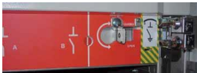
Panel czołowy z otworami operacyjnymi odłącznika szynowego
