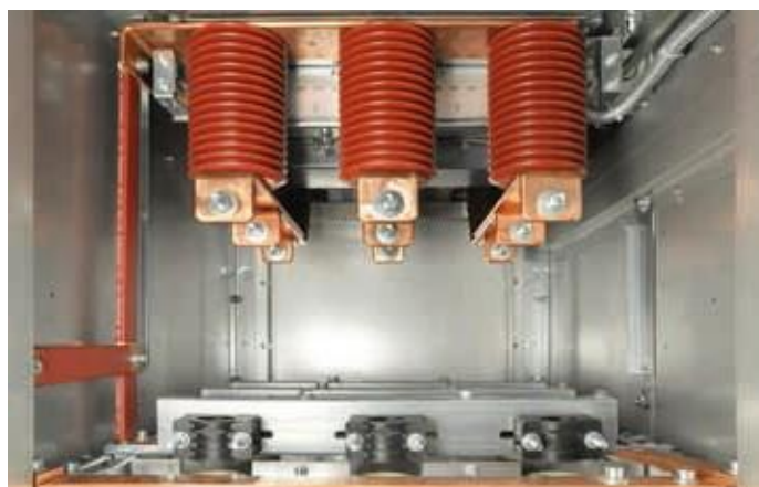
Pierwotny element przełączający zamontowany w przedziale przyłącza kablowego
