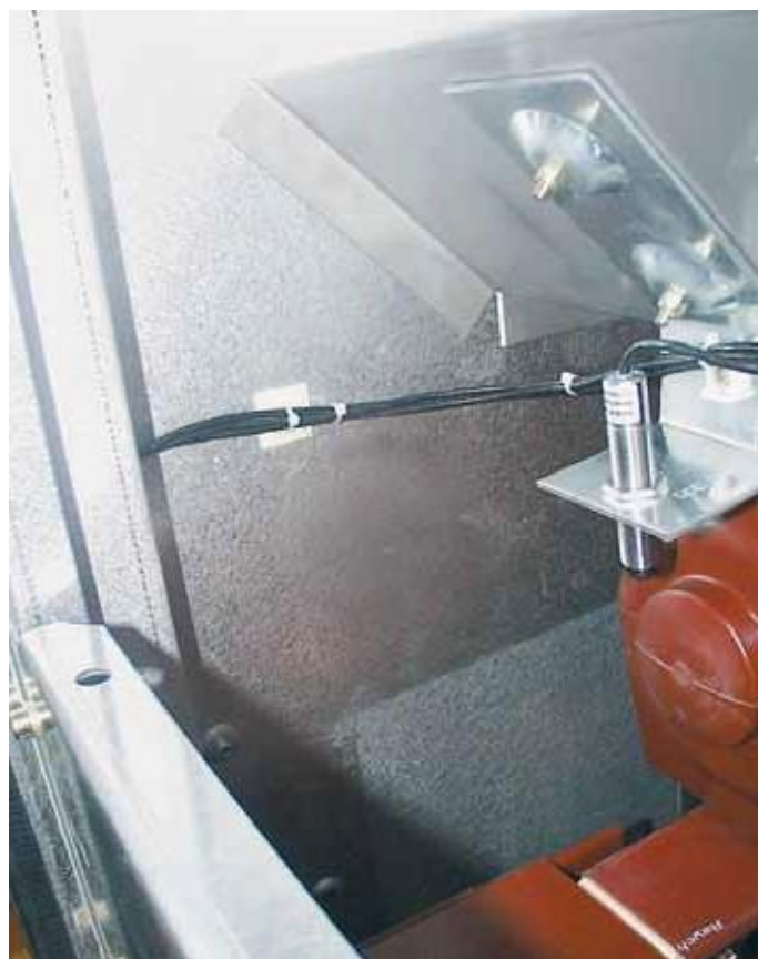
Przykładowy czujnik termograficzny w jednopoziomowej rozdzielni UniGear ZS1
