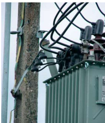
początek linii napowietrznej nn
