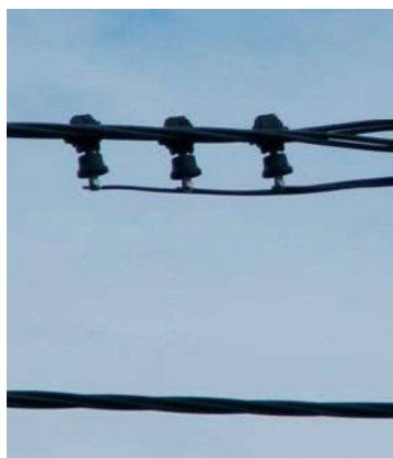
linia główna 1 komplet ASA co 500 m
