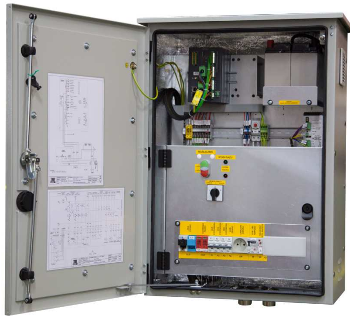
Fot. 3.1 Szafa sterownicza SO1/THO
