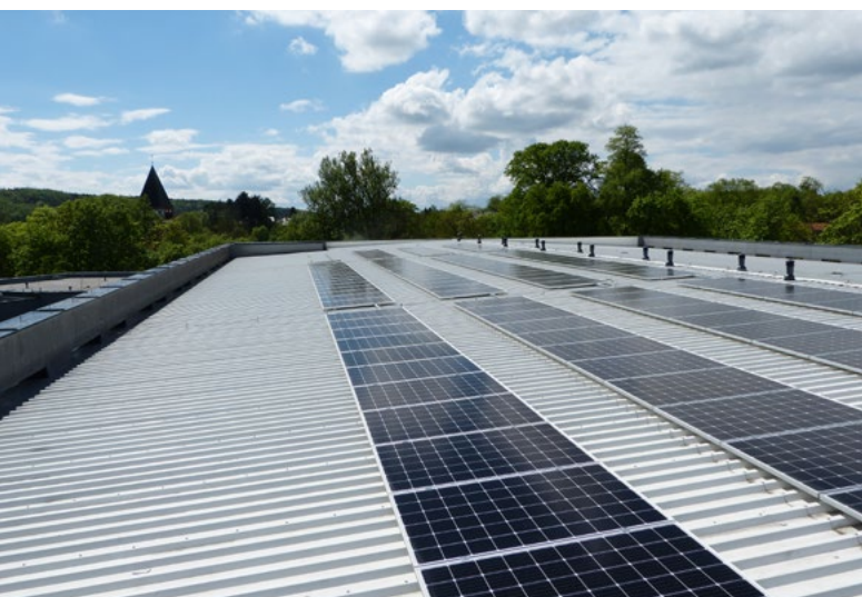
Instalacja fotowoltaiczna w szkole podstawowej w Przywidzu [W. Radziszewska, 2021]
