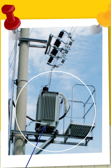
Transformator na słupie energetycznym
