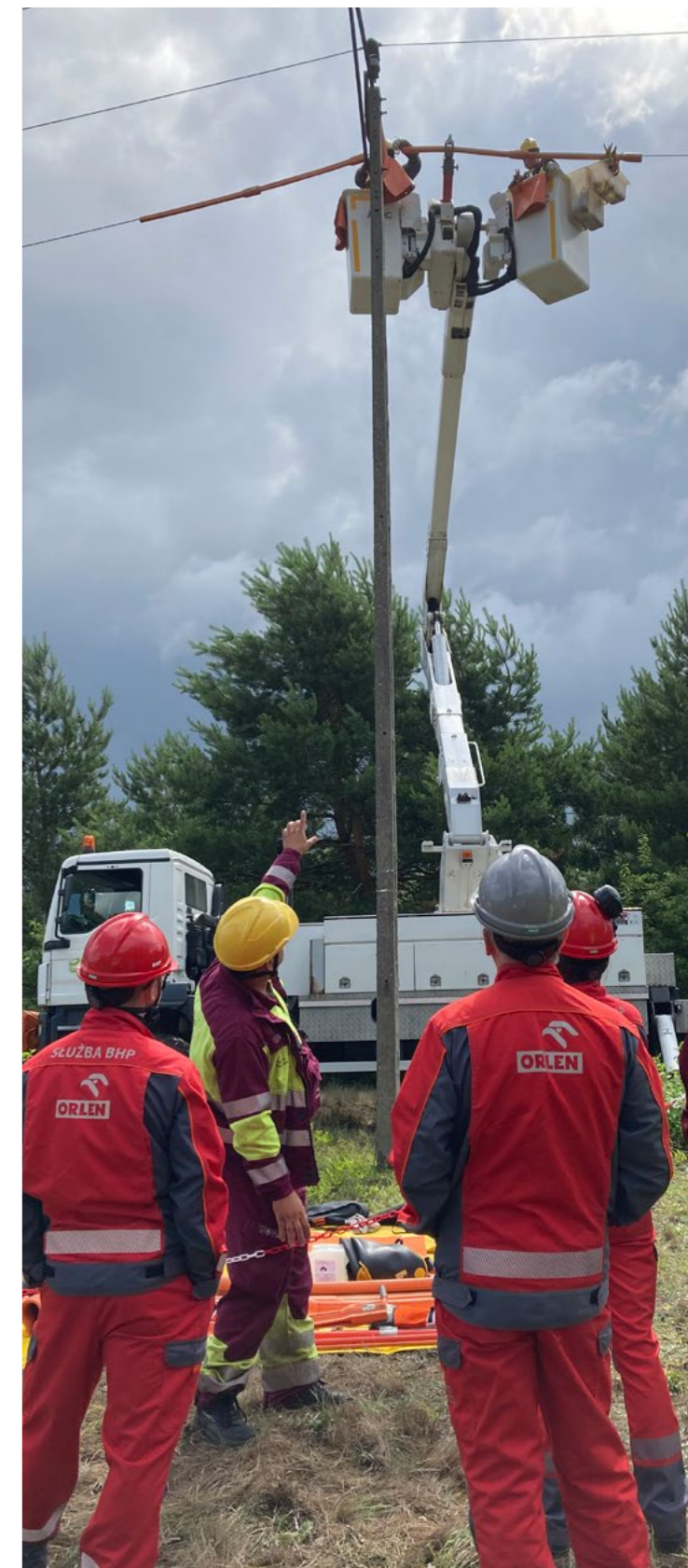
Wizyta doradcza służb BHP spółek Grupy Kapitałowej ORLEN podczas prac w technologii pod napięciem na linii 15 kV realizowanych przez Energa-Operatora Oddział w Toruniu.
