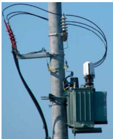
zabezpieczenie uproszczonej stacji transformatorowej 15/0,4 kV
